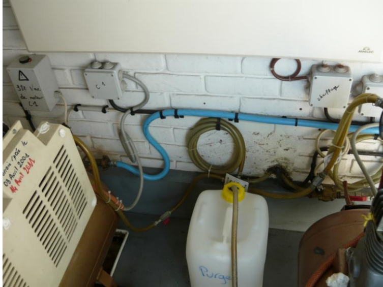
Photo 3. Liaison air et électricité inter-appareils.
